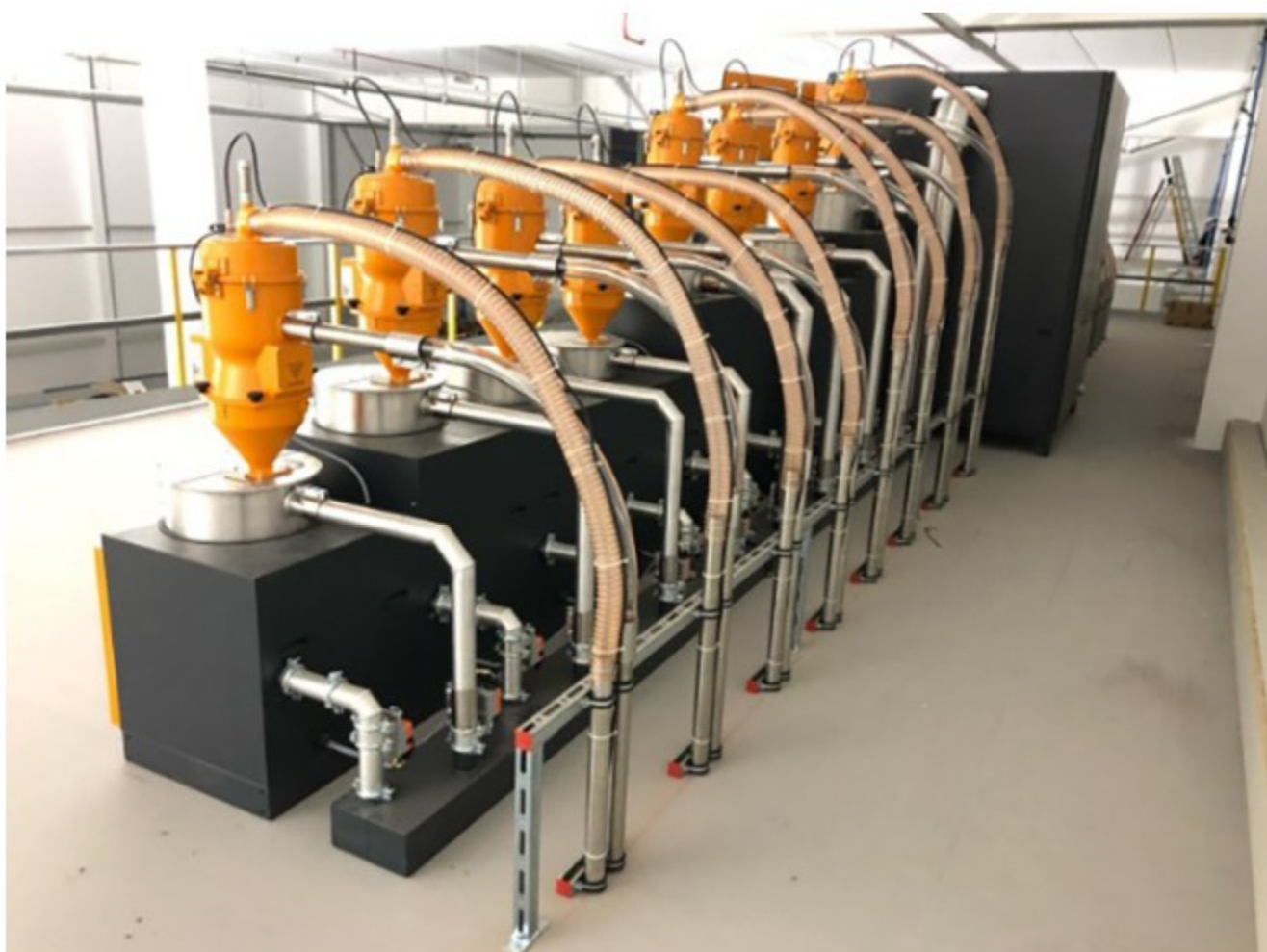
Die EKO-N-Trocknungsbehälter sind hier in den Bühnenboden eingelassen und verfügen auf der Rückseite über die patentierte KOCH-ÖKO-Energieanlagensteuerung. Behälterbefüllung über Förderanlage mit Abscheider A8 und Zwischentrichter Z5.
